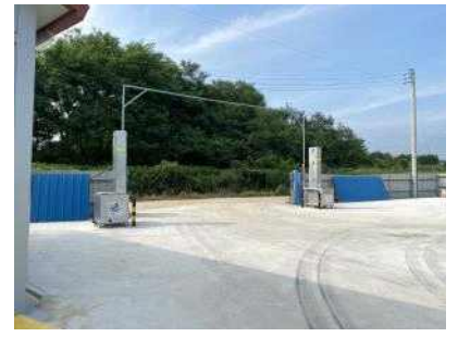
<차량방역시설 설치> (냉동·저온 저장시설 입구)
