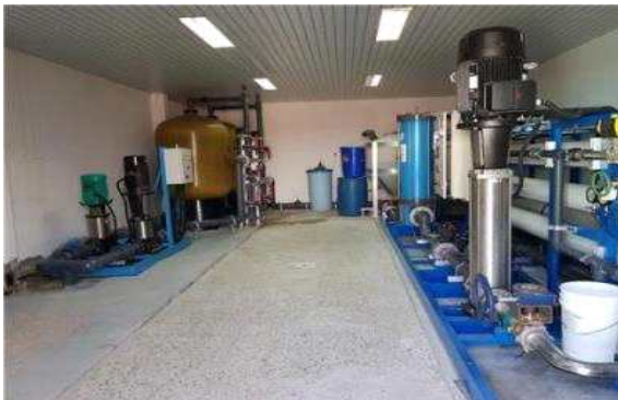
<카타르 염수처리용 설비(RO)>
