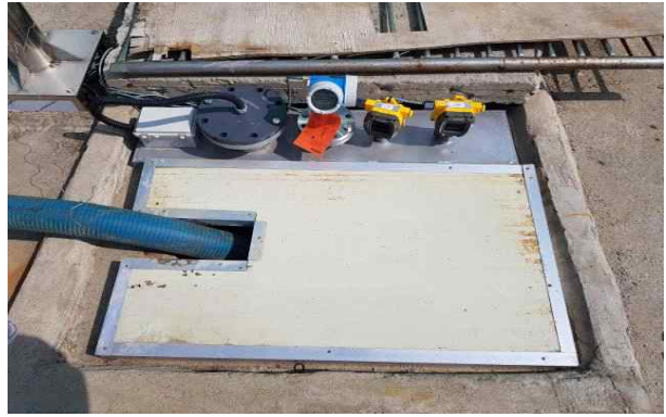
저장조 덮개 및 센서 설비 모습
