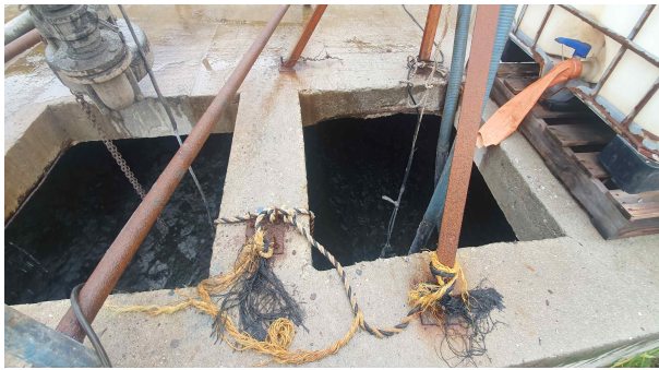
매립형 콘크리트 저장조 (덮개 無)
