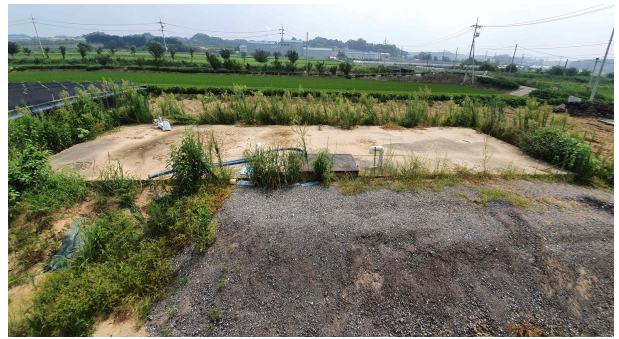
매립형 콘크리트 저장조 (덮개 有)
