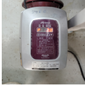
(▲), (▼) 단추를 눌러 양액펌프 압력을 2.0으로 설정해 줌
