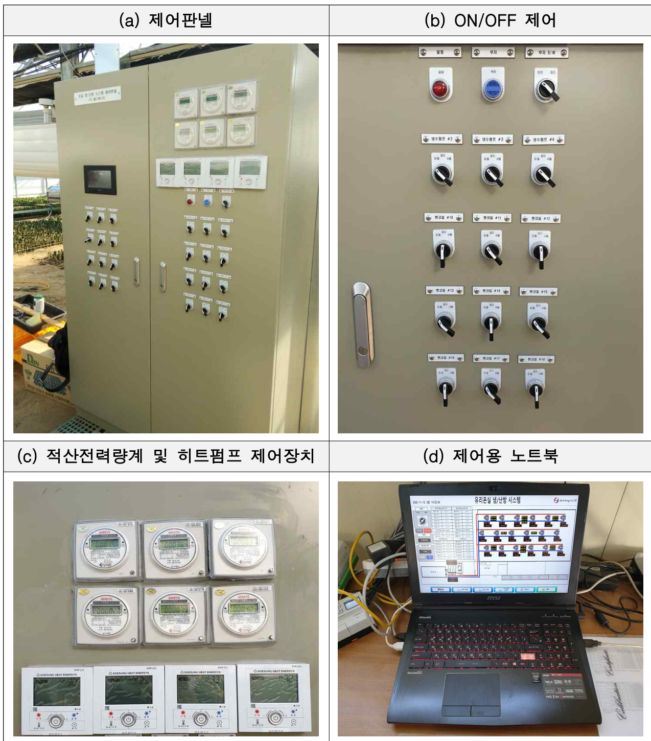
[그림 67] 제어판넬 설치 사진
