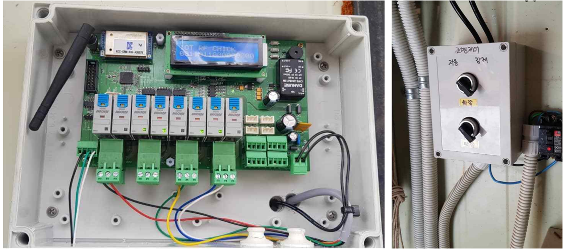
그림 114 조명제어기 현장 설치 사진
