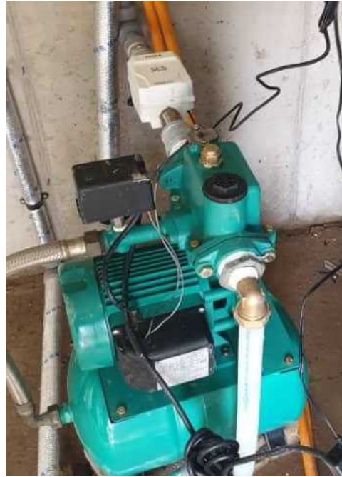
그림 80 초음파 수도미터 설치 상태
