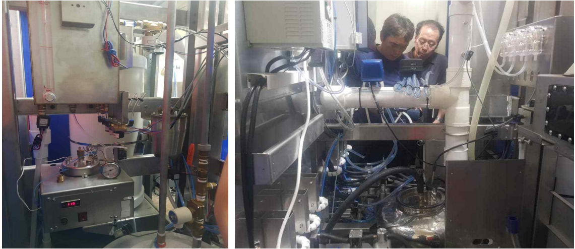
그림 194 기기 내부 장치 연결 및 작동상태 점검
