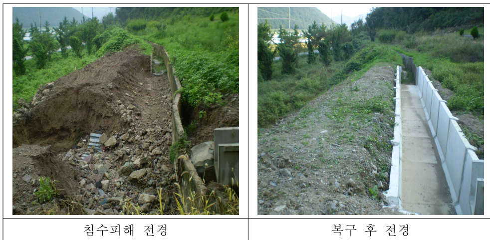
<표 2-10> 고곡지구 침수피해사례
