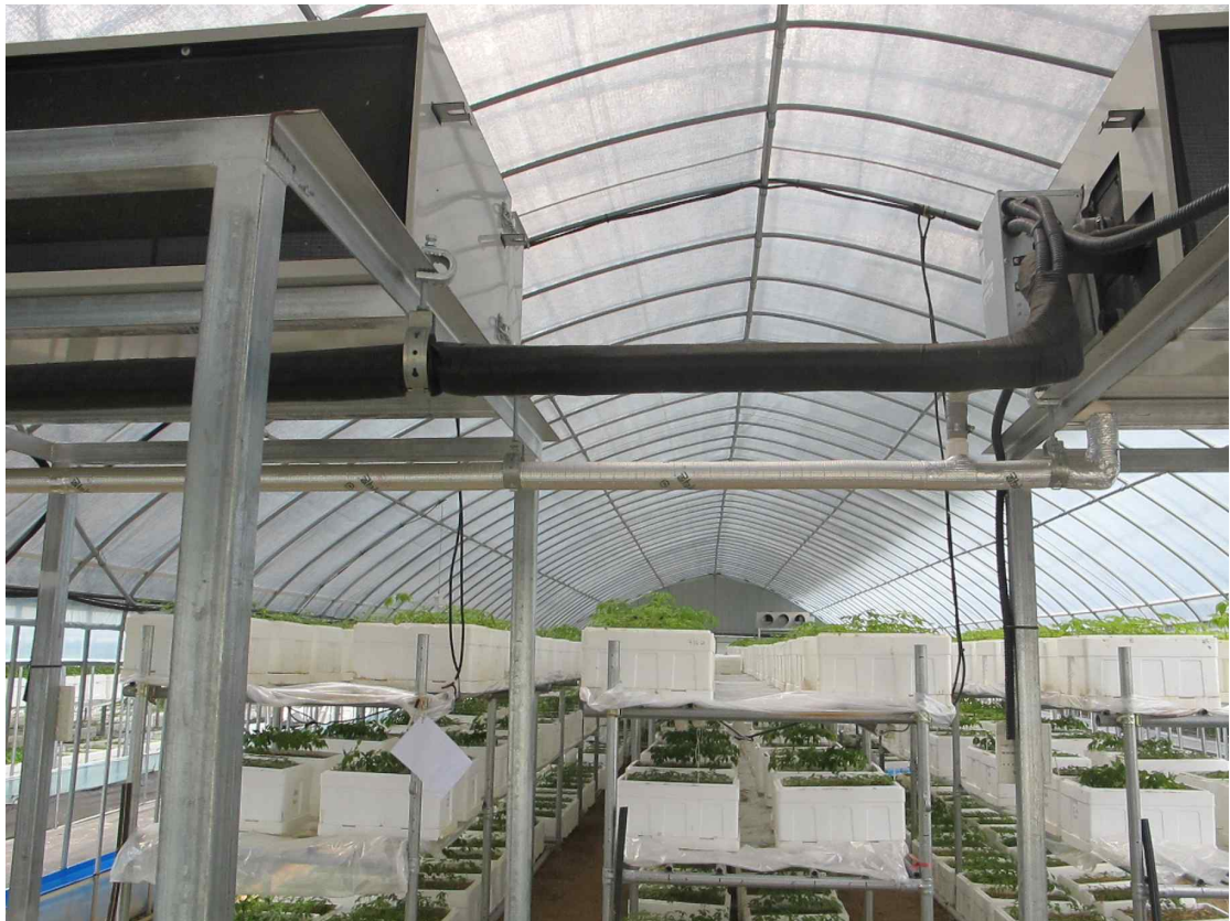
사진 9. 온도제어 하우스 내부 냉방시설
