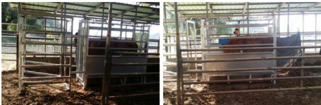
그림 13. 대가축용 체중자동측정장치 현장 설치
