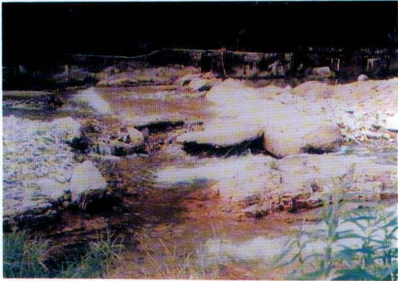
◁ 집중호우와 태풍 '올가'의 영향으로 강원도 화천군 하남면 안평리의 삼지보가 유실(L=30m) 및 복구된 광경 ('99. 8)
