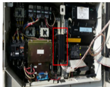
컨테이너 내부환경 모니터링 장치 설치
