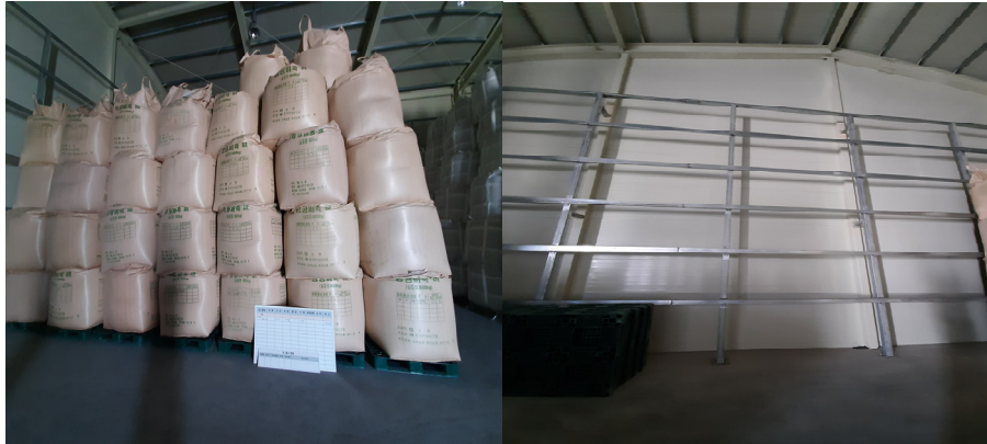
부도7. ○○보관창고 외벽 지지대 전경
