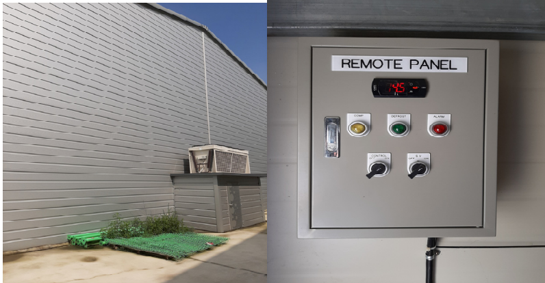
부도5. ○○보관창고 온도유지시설 전경
