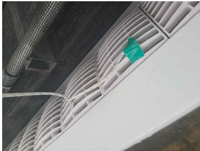
(d) 열교환기 온도 측정
