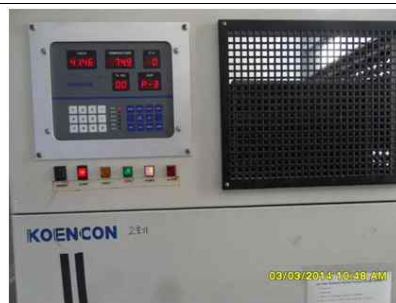
그림 6. DHT control box.
