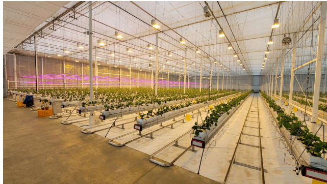
그림 53. 하이브리드 보광등 설치구역 사진
