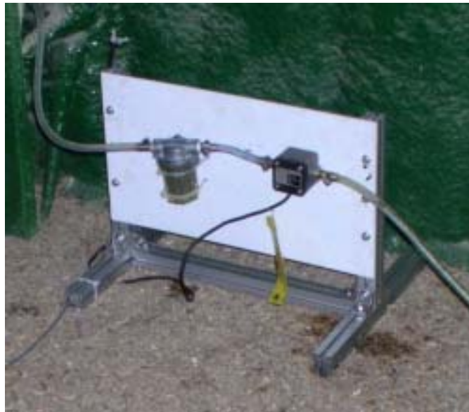
그림 3-5. 난방용 연료 소비량 센서 및 연료 필터
