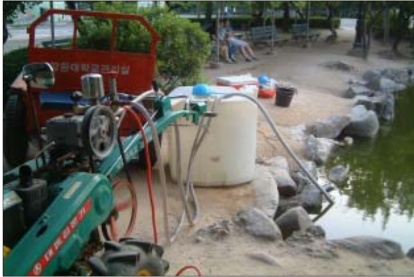
[그림 3.3.36] 응집제 투여 장비 - 저장탱크, 수중펌프, 고압 펌프
