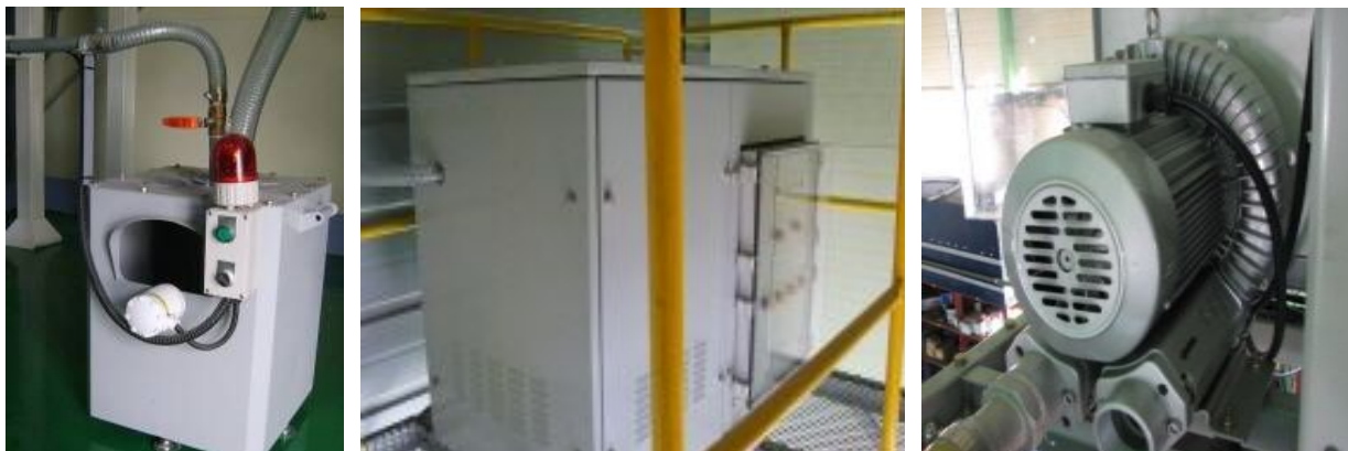
((좌)곡물 및 부산물 수집탱크, (중)곡물 및 부산물탱크, (우)공기이송에 사용된 ring blower)
