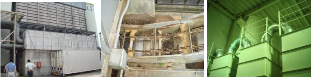
그림 2-2-3. 일본 CE에 설치된 세정식집진시스템과 정미공장에 설치된 혼합집진방법
