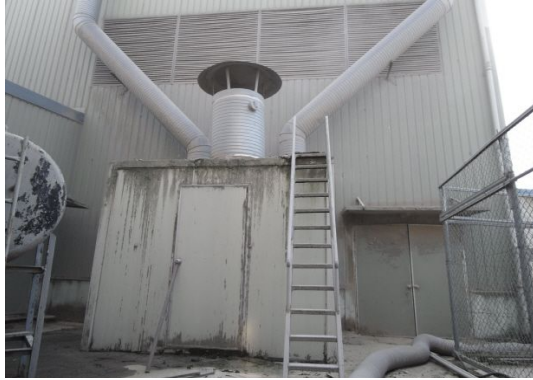
사이클론 통과후 추가 분진포집 탱크
