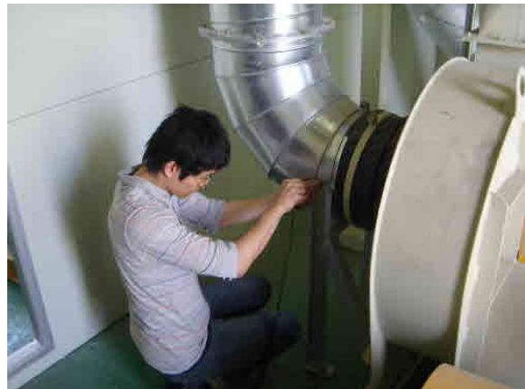
(집진기의 송풍량 및 정압 측정)
