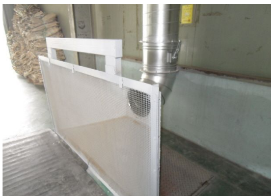
신규로 설치한 투입 집진구
