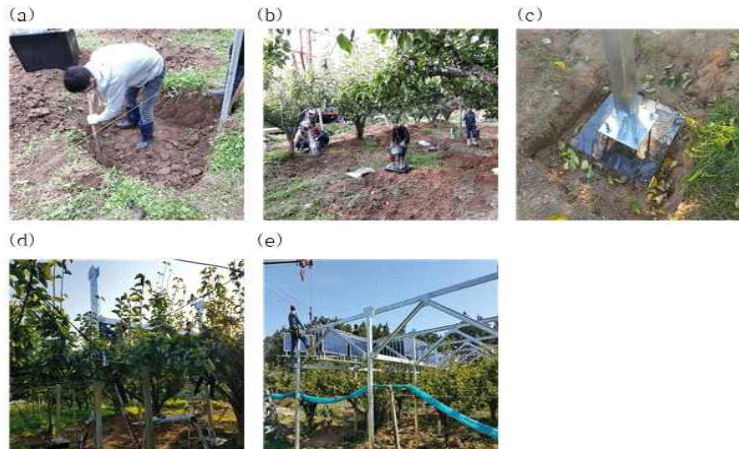
그림 58. 10kW급 배전용 접이식 구조물 구축 과정; (a) 기초시공, (b) 독립기초시공, (c) 주 기둥 시공 그리고 (e) 상부 구조물 및 모듈 시공.
