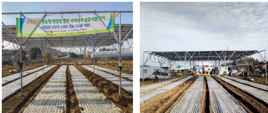
그림 52. 태양광 이모작 10kW급 받 실증단지 구조물 구축 완료 모습.
