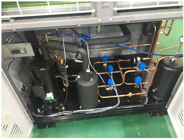
(e) 향온항습기 실외기 내부 배관 사진
