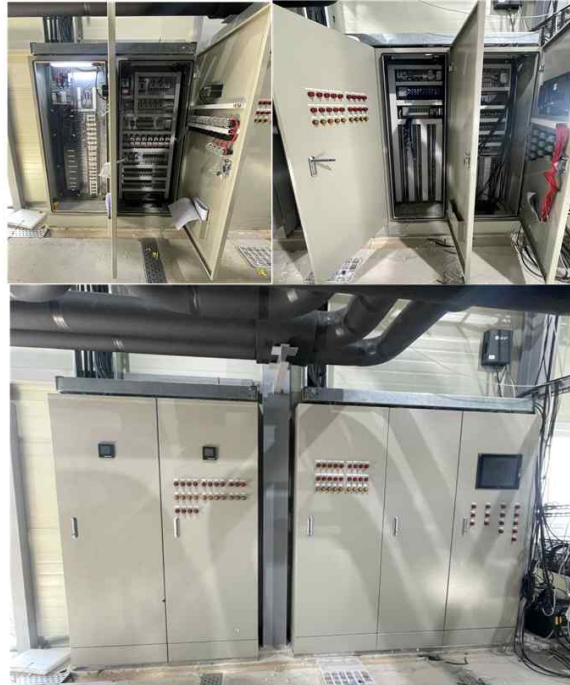
[그림 4-66] 제어를 위한 MCC 및 PLC 판넬 전경 사진
