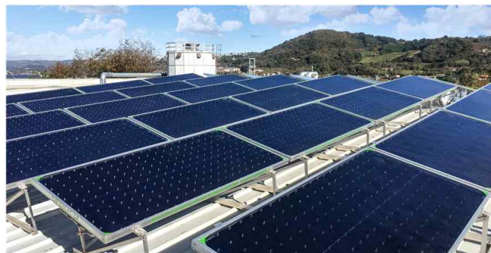
[그림 3-12] 스위스 TVPSolar사의 진공식 평판형 집열기 설치 모습 (자료출처: TVPSolar systems, the clean energy production that saves money, Solar Process Heat, January 2020)
