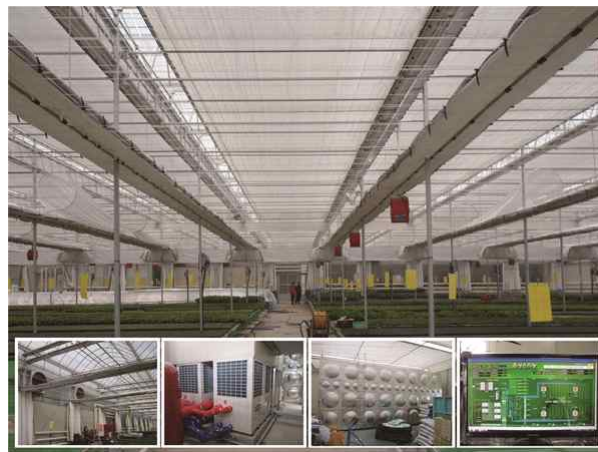
[그림 3-16] 태양 잉여열 축열식 히트펌프 설치농가
