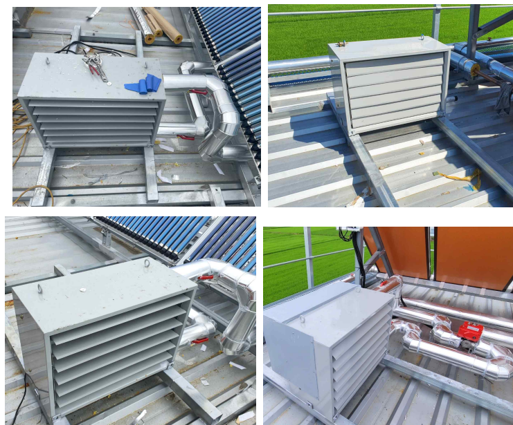
[그림 4-102] 태양열 과열방지를 위한 집열기 1차측 방열기 설치 사진
