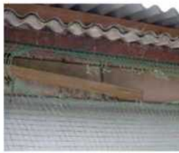
발상 계사 방조망 파손
