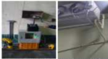
이산화염소 저농도 지속 발생장치 및 농도측정 센서
