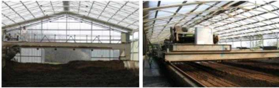
| 퇴비화시설 안개분무시설 설치 사례 |
