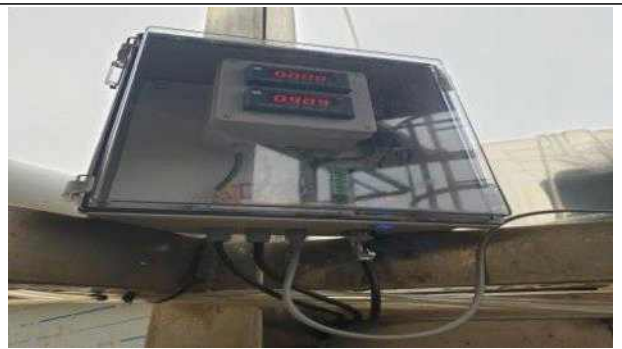
탈취시설(황산활용) 및 센서 연결 컨트롤러
