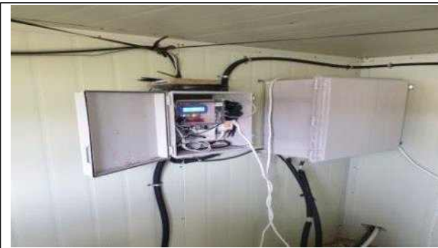
안개분무&바이오커튼 및 센서 연결 컨트롤러
