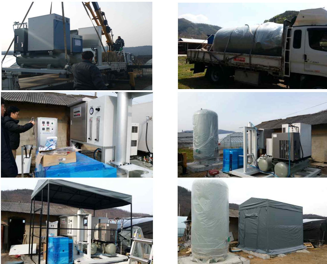
그림 61. 수정보완된 CO 2 포집 및 공급 시스템의 현장 설치
