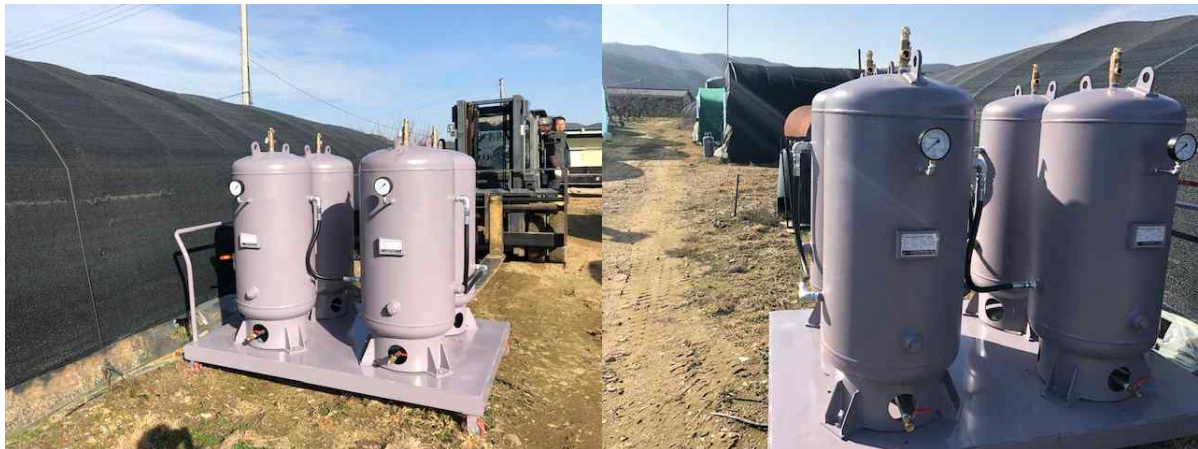
그림 89. 멤브레인 CO 2 저장 및 공급 시스템의 시설재배 하우스 측 설치
