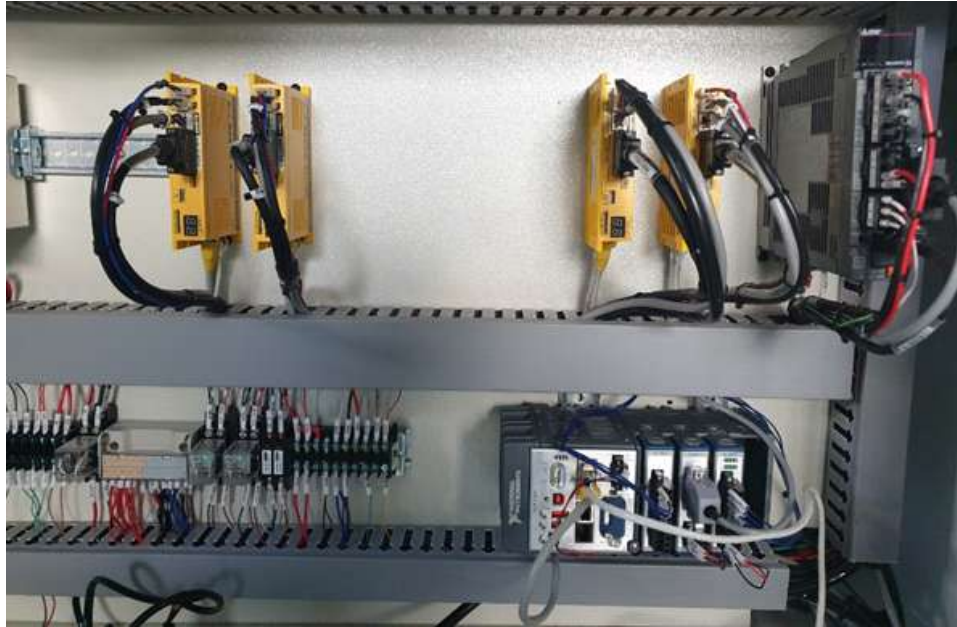
그림 114. 전용 Pump 및 DC Power Supply 통합 제어 시스템
