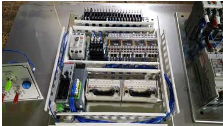
그림 6. PLC 자동제어장치 개발
