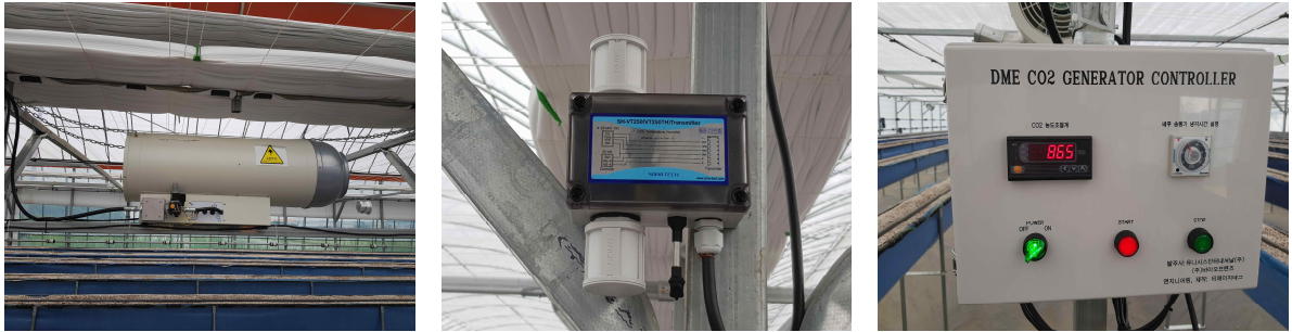
그림 2-29. CO2 발생기, CO2 센서 및 컨트롤러 설치
