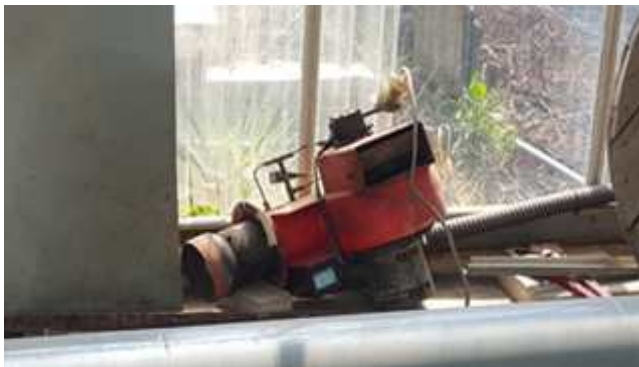
(a)보일러교체 전 버너(등유보일러 버너)
