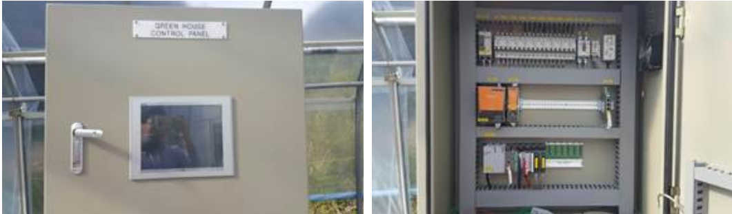
그림 2-12. 공주 Green House control Panel
