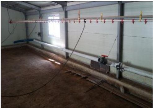
【 내부 이송배관 및 개폐장치 사진】
