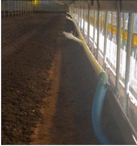
【 내부 이송배관 및 개폐장치 사진】
