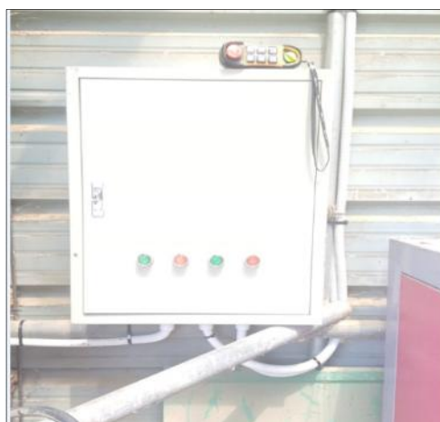
【 내부 컨트롤함 설치사진】
