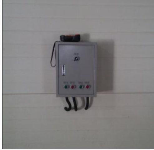
【 내부 컨트롤함 설치사진】
