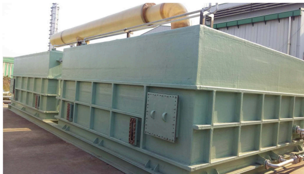
악취제거 설비 전경
