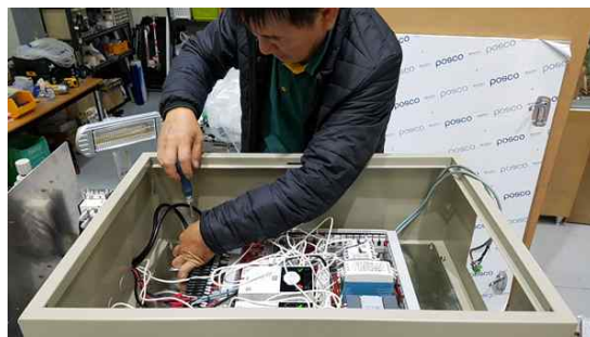
그림 33. PLC 제어컨트롤러 판넬
