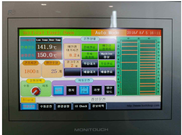
그림 35. 컨베이어 건조기 외부 조작 스크린
