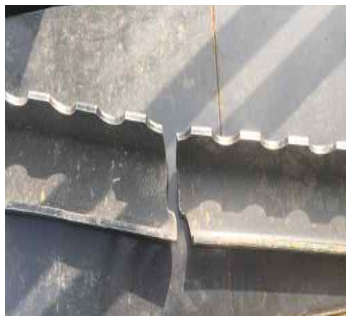
<브라켓 파손 사례>
