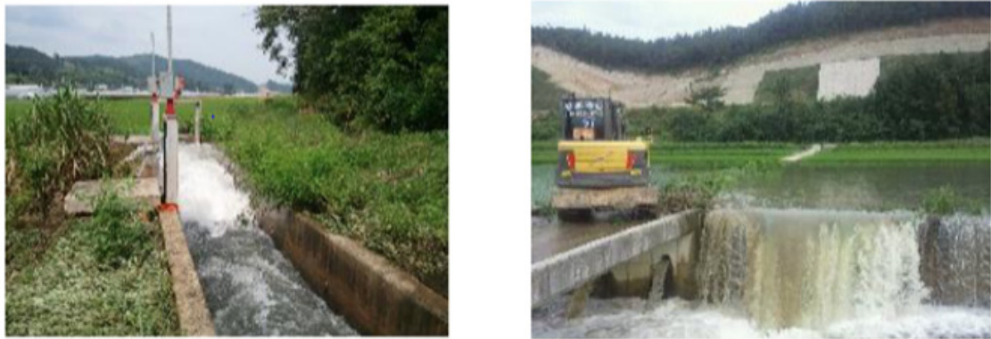
(그림 1-153) 운저수지 폐통관 누수 피해 전경
