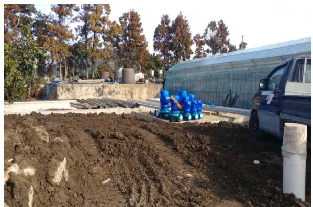
[그림 38] 지열공 기계실 전경
