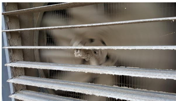
그림 3-3-2 측정 대상 터널배기팬에 축적된 분진
