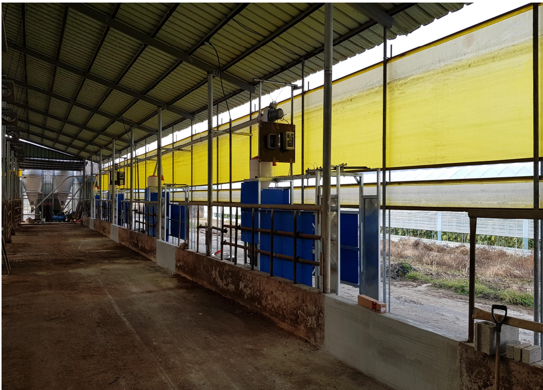
그림 160 한우용 자동사료 급이기 현장 설치 환경
