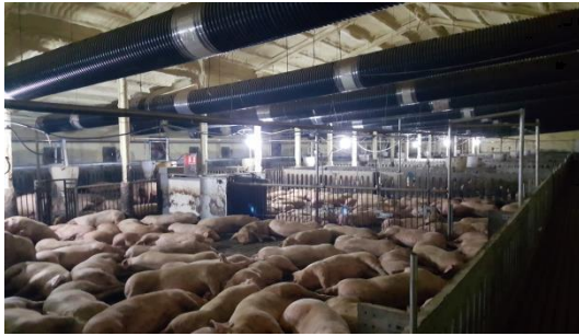
(a) 비육돈사 내부 현황 및 입기덕트
