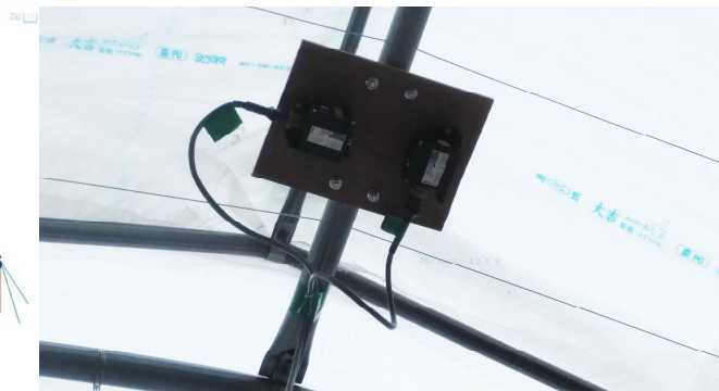
[2-2] 그림 5. 가속도 측정모듈 설치
