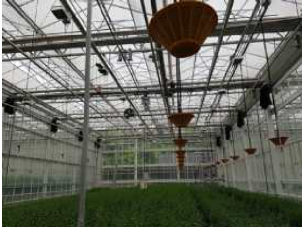
천정에 설치된 각종 설비
