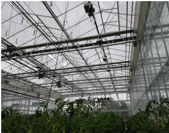
천정에 설치된 각종 설비
