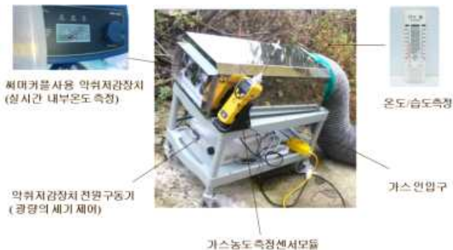
[그림 3-120] 능동형 나노광촉매 악취저감장치 설치사진도
