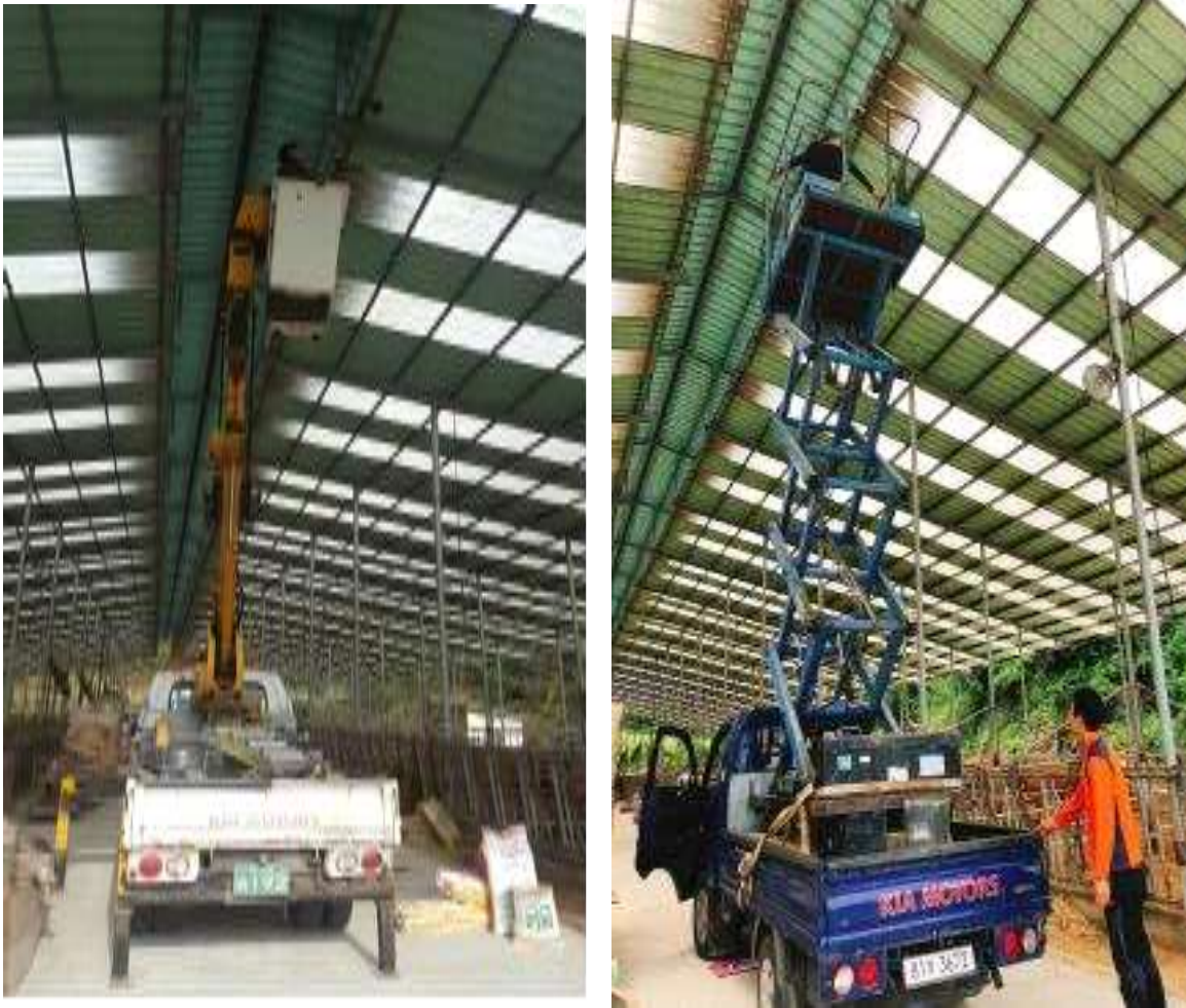
Figure 40. 열화상 카메라와 광각 카메라 현장 설치 모습
