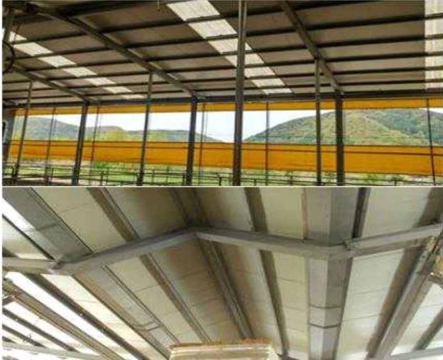
Figure 65. 우사의 천장과 측면부에 설치된 자동제어형 원치 커튼
