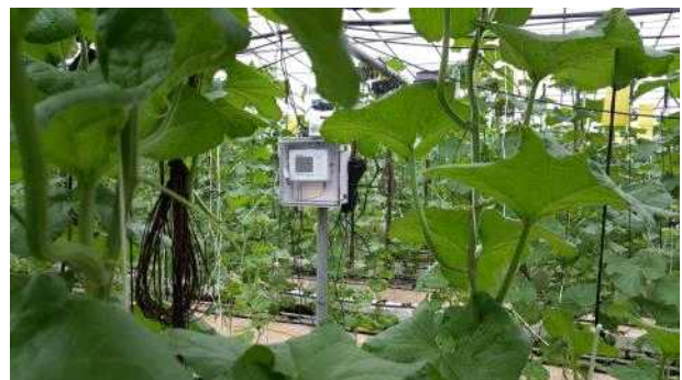
< 환경 측정용 계측기 설치 >
