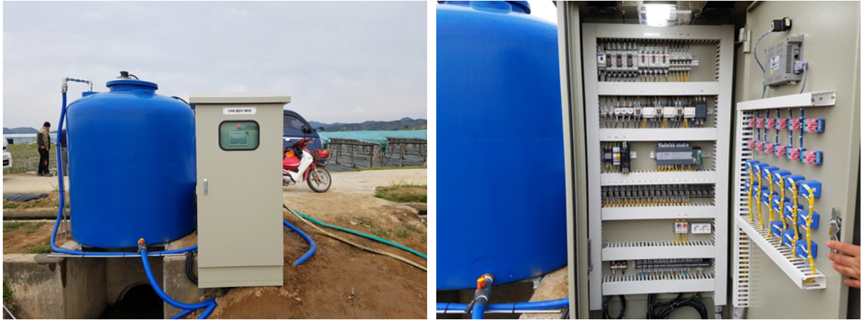
그림 2.2.20 프링클러 관개 및 배수제어용 제어반
