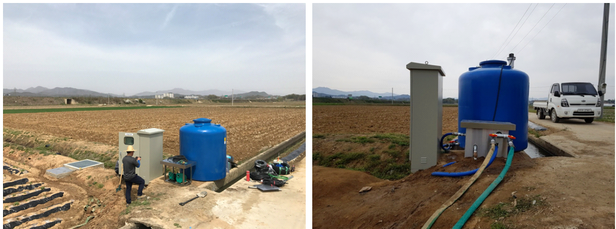
그림 2.2.19 프링클러 관개용 펌프
