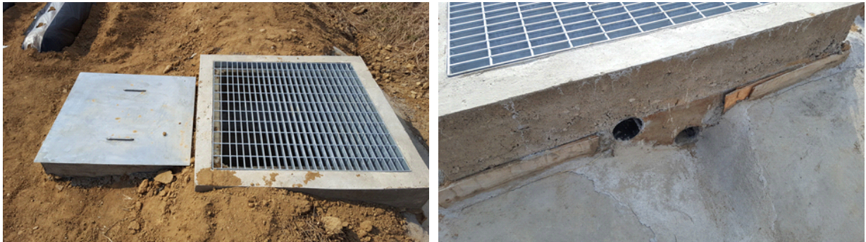
그림 2.2.31 테스트베드 말단부 배수조절 밸브 및 집수맨홀
