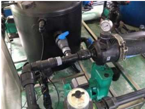
<압력조절밸브 설치 전>
