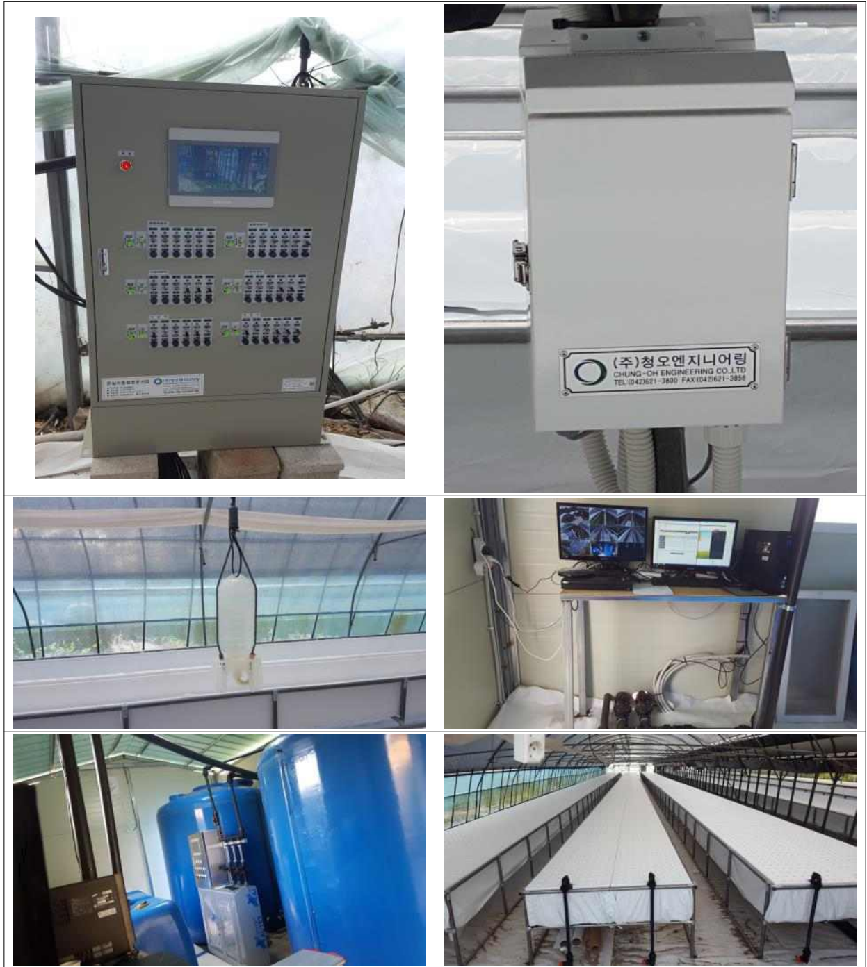
<순창 ICT 활용 시설재배 농가 설치 모습>
