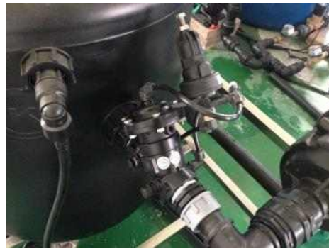
<압력조절밸브 설치 후>
