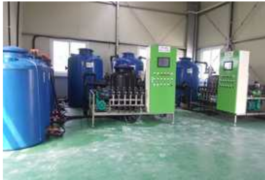
<과채연구소 양액기 설치 현황>
