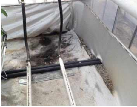
<펌프 설치 전>
