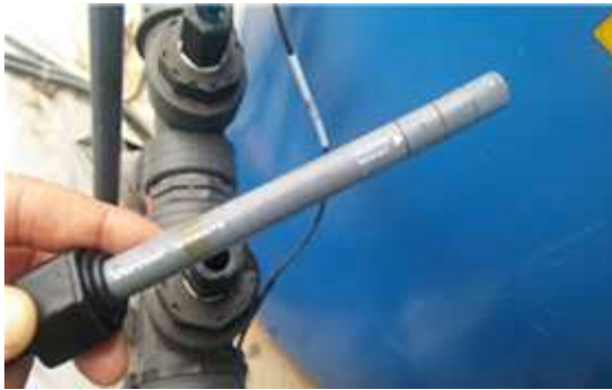
<설치된 질산태질소 센서>
