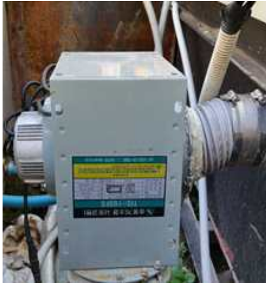
[그림 2.9c] 실험돈사 나동 (㉔수평형 바이오필터) pit벽에 설치된 음압팬
