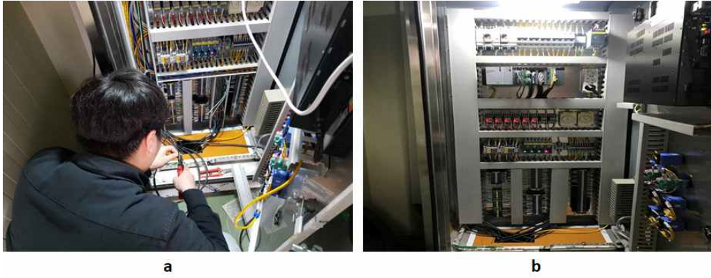
[그림 3.42] 모형돈사 B의 펌프 센서장치를 (a) 연결하는 중 (b) 연결 후
