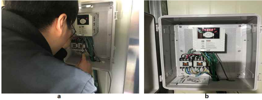
[그림 3.39] 모형돈사A 패널 (a) 인버터 설치전 (b) 인버터 설치후
