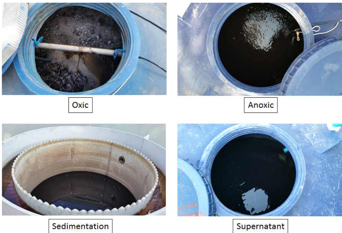
[그림 2.70] 현장에 설치된 돼지 분뇨 처리 탱크
