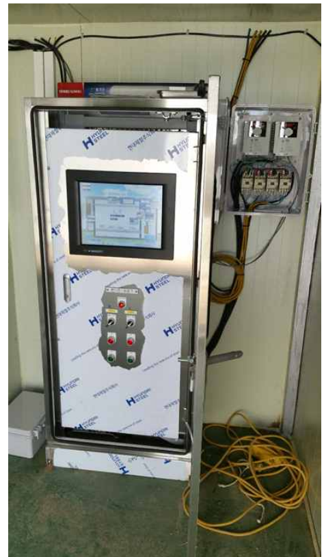
[그림 3.44] 모형돈사 사육실-바이오필터 touch screen 컴퓨터 패널 PLC
