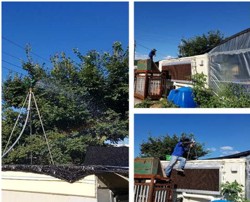
[그림 3.168] 한 여름 전도열 저감 돈사지붕 스프링클러 설치
