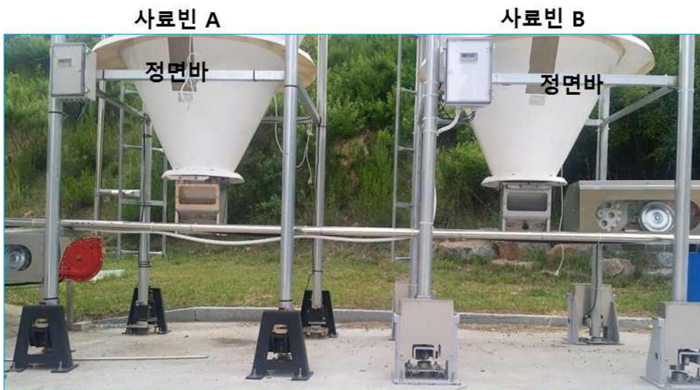
테스트베드 내 사료빈 자동관리기 설치 현황, I사 (좌), C사 (우)
