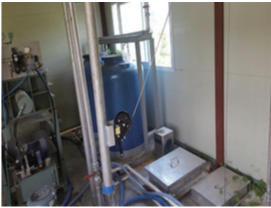
〈약품 반응 탱크 및 수증교반기 인양대〉
