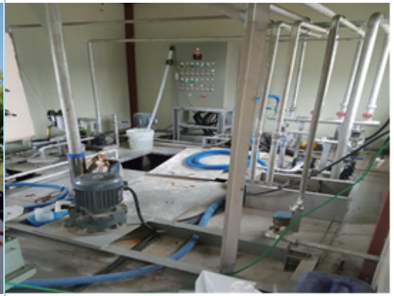
〈착유세척수 처리시설 내부전경〉
