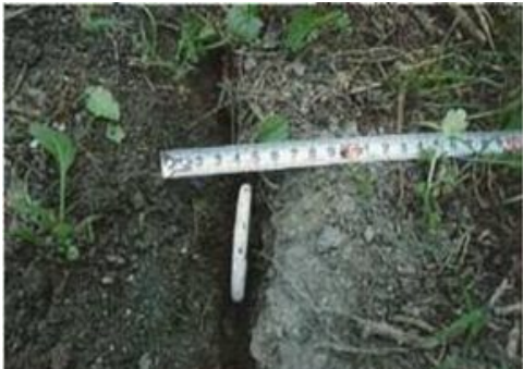
① 지진후 제방 균열
