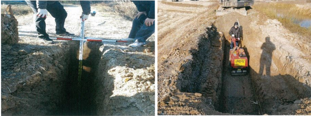
(a) 응급복구-균열깊이 확인
