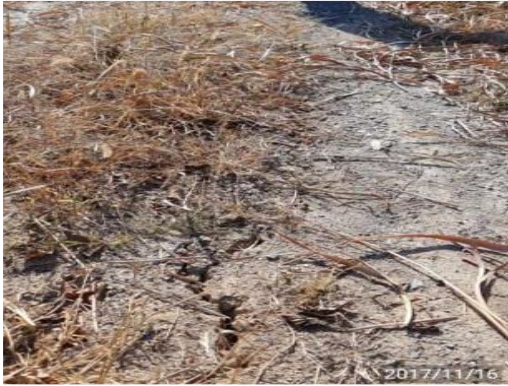
(a) 댐마루 종방향 균열
