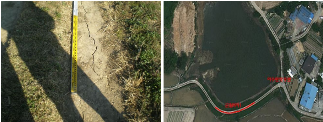
(a) 댐마루 중간부 종방향 균열
