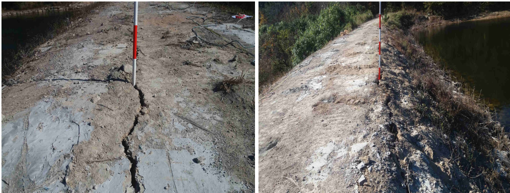
(a) 댐마루 종방향 균열(No.3+5)
