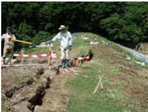
(a) 지진후 제방 균열
