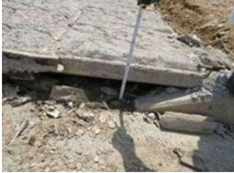
① 보호블록 하부 공동 확인
