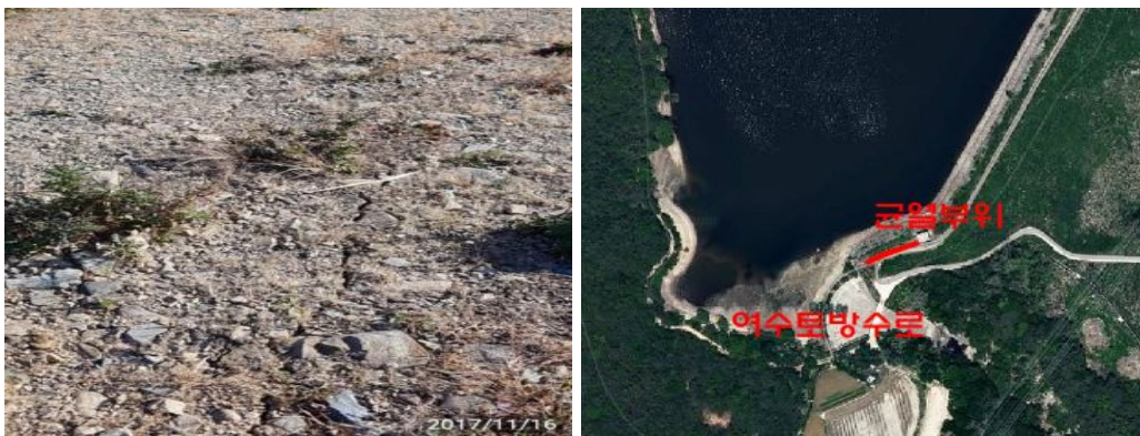
(a) 제방 댐마루 종방향 균열
