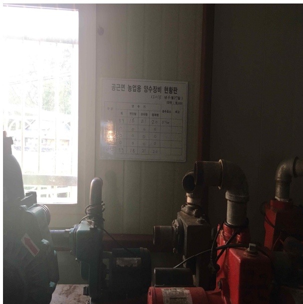
양수기(황성군 공근면사무소)-점검 조치 後
