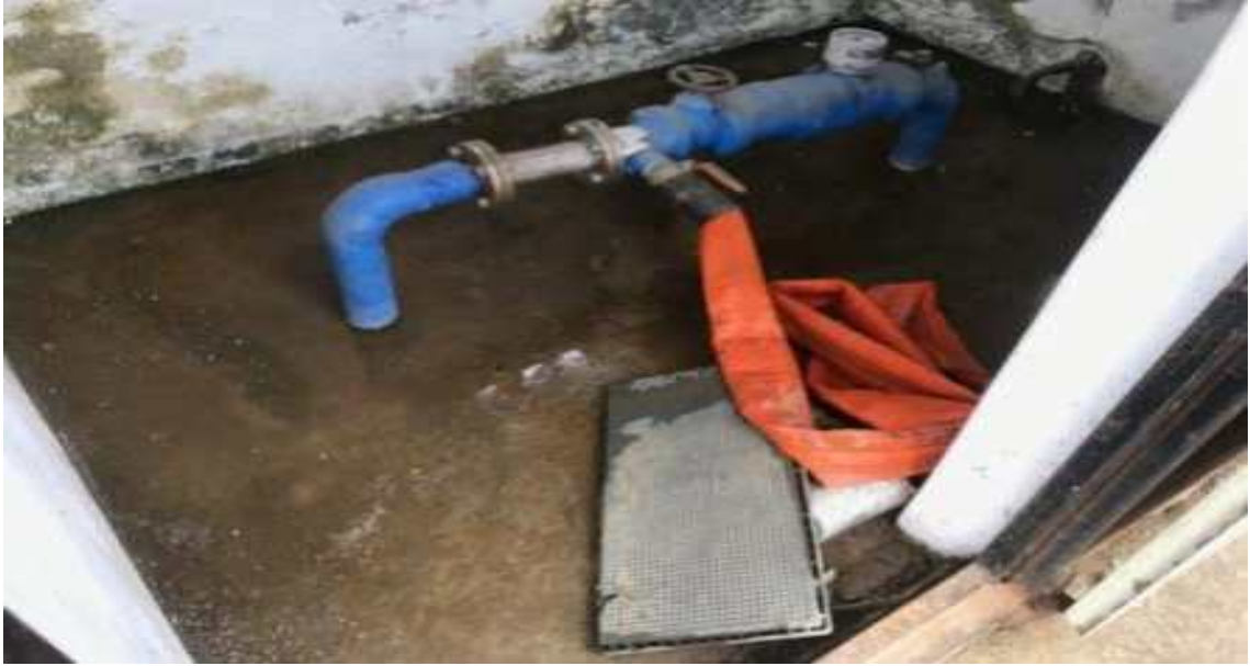
용강리 관정(증평군 증평읍 용강리)-점검 前
