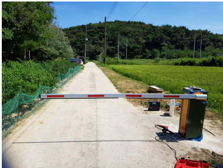
그림 106. 축사 차량 출입 개폐기의 닫힘 상태 확인
