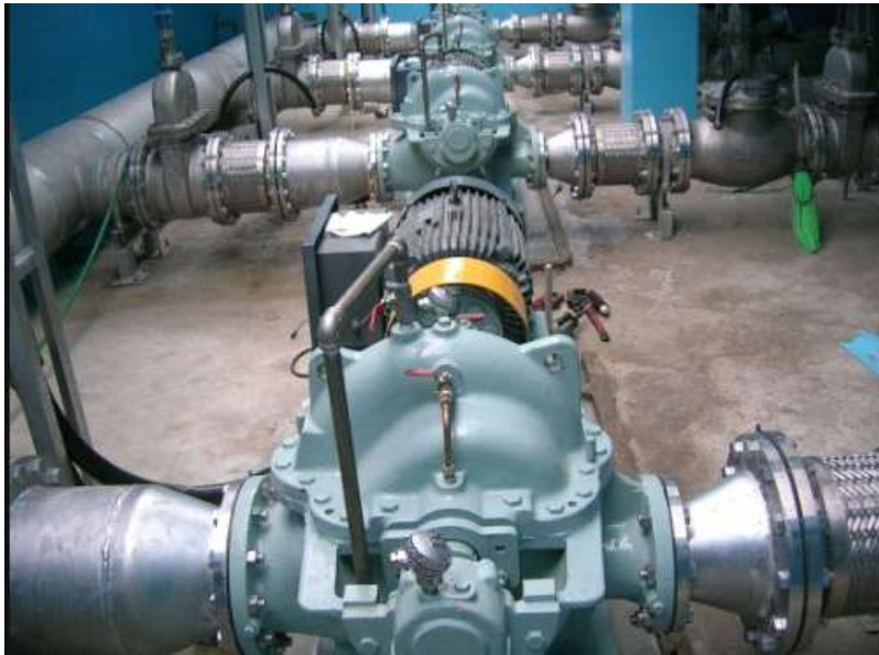
그림 3.2 양배수장의 설비 전체도 및 설비 전경 사진
