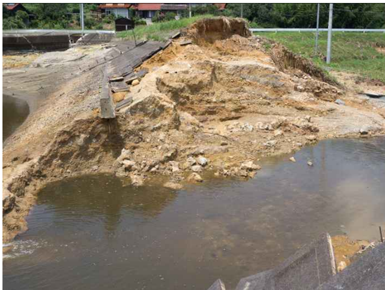
그림 2.4 호우로 인한 저수지 제체의 붕괴
